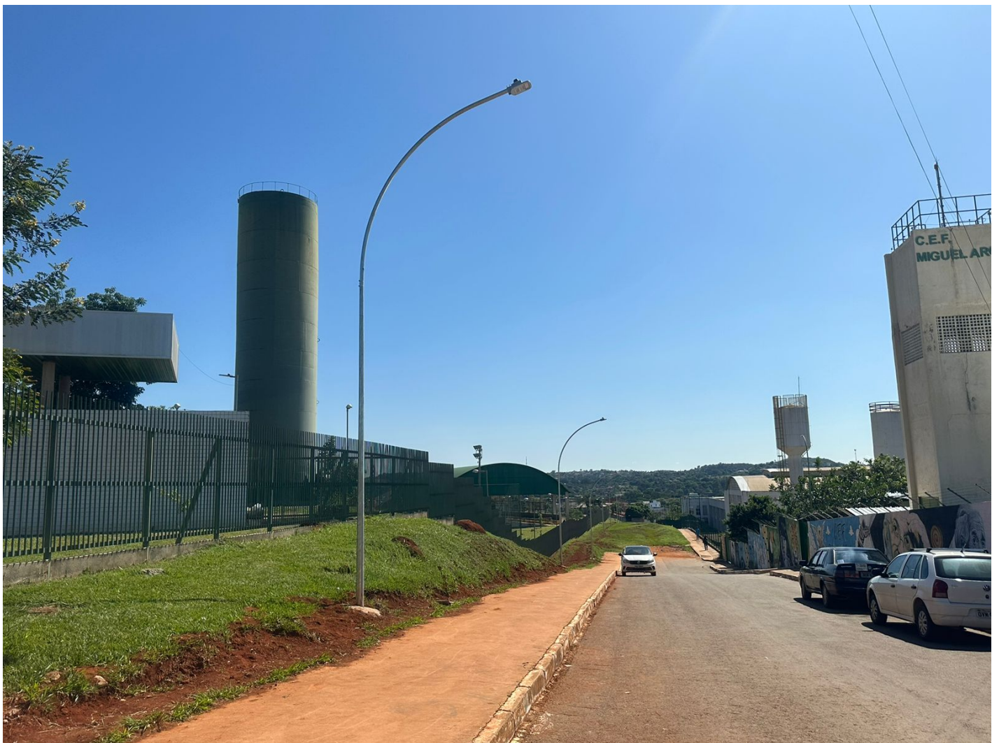
Figura 03: Ampliação da Iluminação Pública entre o Colégio Miguel Arcanjo/IFB no bairro São Bartolomeu, no Núcleo Urbano de São Sebastião - DF.
