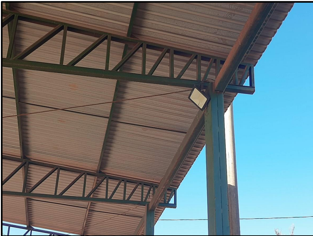
FOTO 13 – FOTO DO ESTADO ATUAL DA QUADRA DE ESPORTE, REFLETORES
