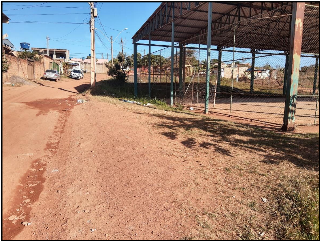
FOTO 15 – FOTO DO ESTADO ATUAL DA QUADRA DE ESPORTE, PILARES E COBERTURA
